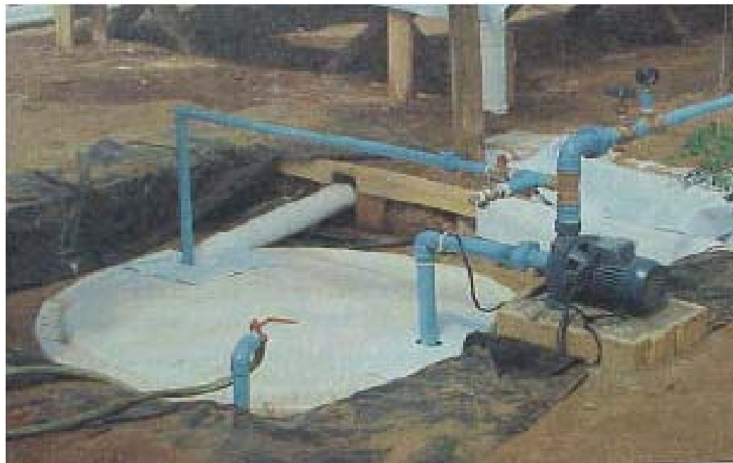
Fotografía N° 6.2. Bomba impulsora no sumergible instalada con el estanque colector.
