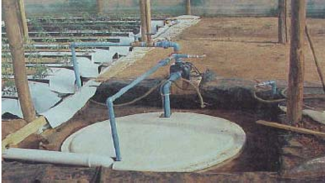
Fotografía N° 6.1. Estanque colector de fibra de vidrio.
